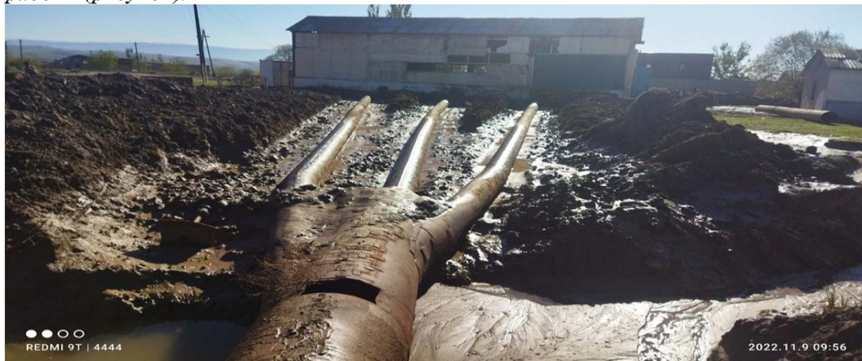
Рисунок.-Трубопроводы насосной станции №26 Хуросонского района
