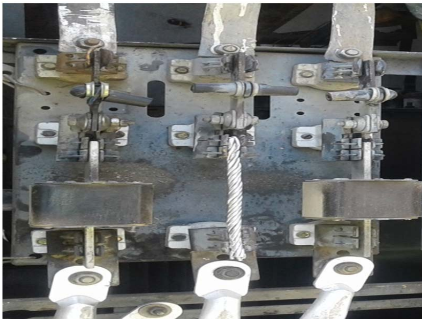
Расми 1. - Нодуруст истифодаи нокили барқие, ки дар ҷойи муҳофизаки зудгудоз васл карда шудааст ва боиси садамаи трансформатор мегардад.
